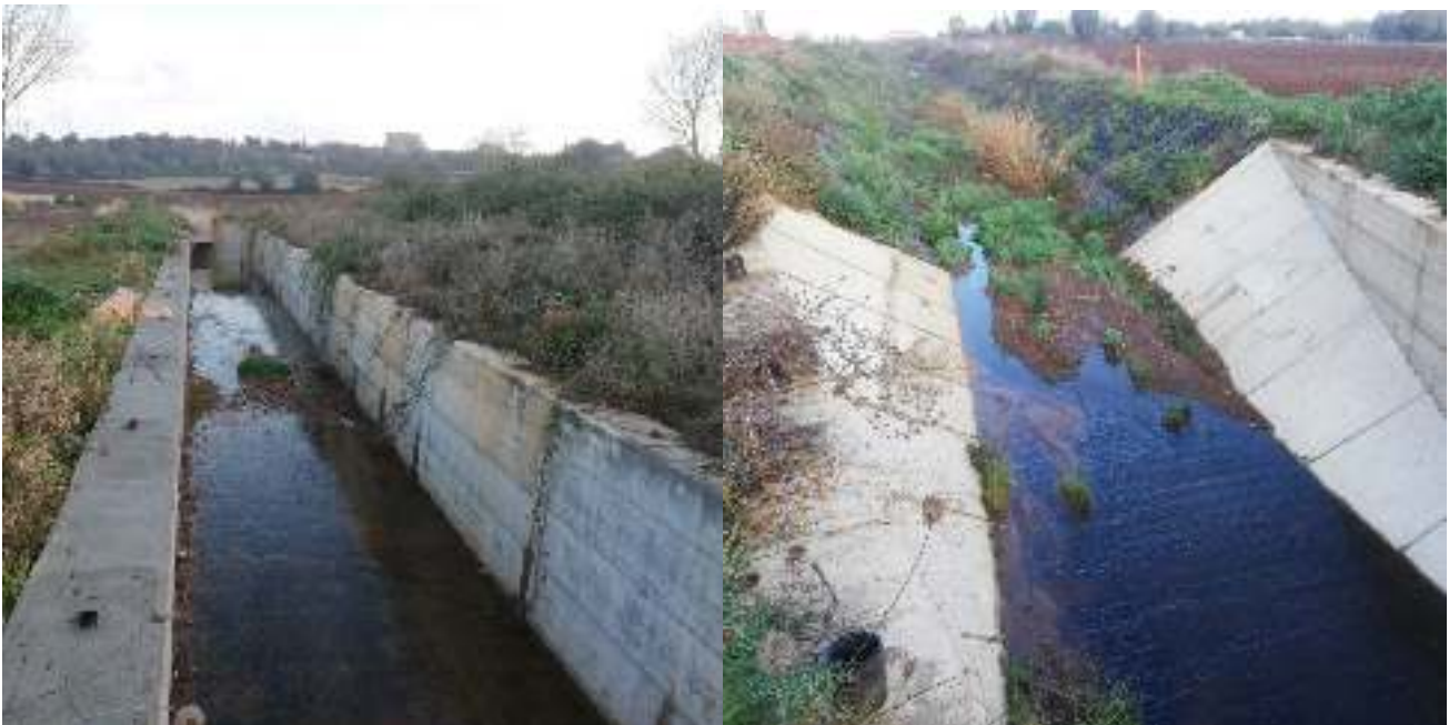
Foto 5 e 6 – (31-12-2020) Tratti completati di canale G-H in c.a. ed H-I in materassi tipo Reno.
