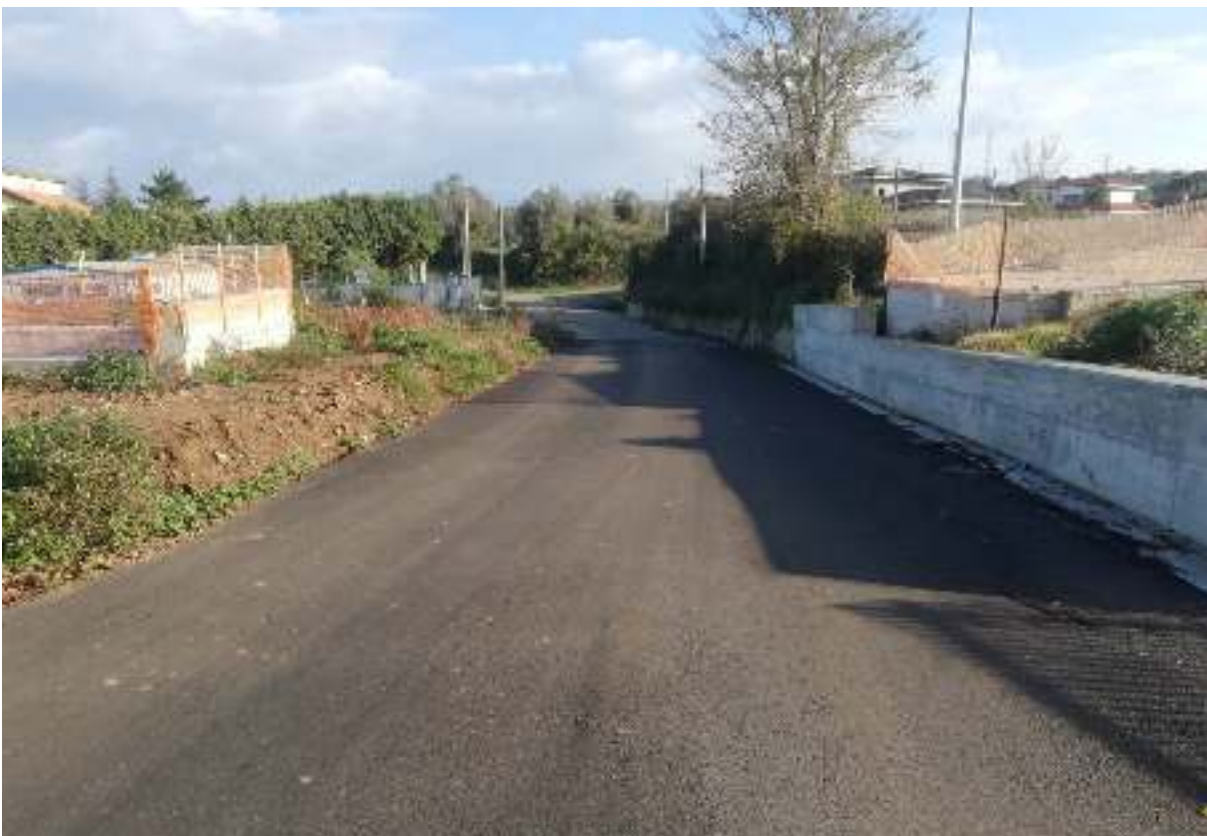
Foto 10 – (31-12-2020) Tombino in c.a. completato nel tratto L-M e relativo ripristino viabilità su Via Cocari.
