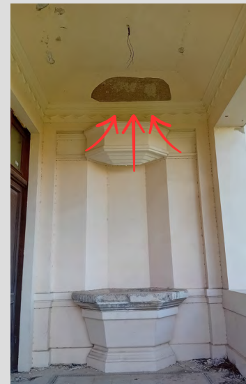
Dettagli del degrado che interessa la struttura.
