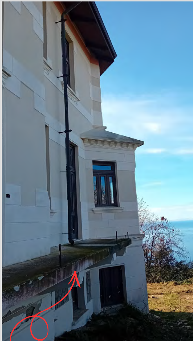
I parapetti e la pavimentazione dei balconi risulta assente. Si evidenziano problemi di umidità.
