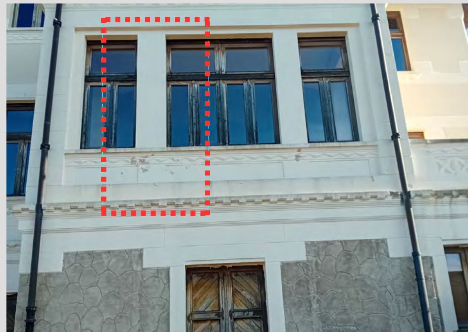
Gli infissi in legno necessitano interventi di recupero, alcune porzioni dei prospetti sono interessate da fenomeni di degrado.
