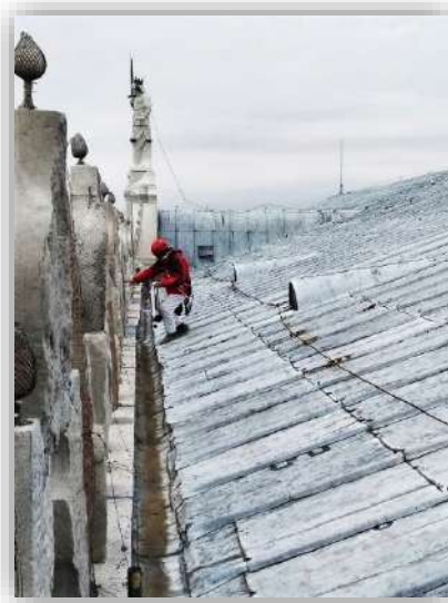
Operatore specializzato mentre esegue un prelievo avvalendosi della linea vita sulla copertura della facciata sud, fronte Bacino di S.Marco, dicembre 2020.
